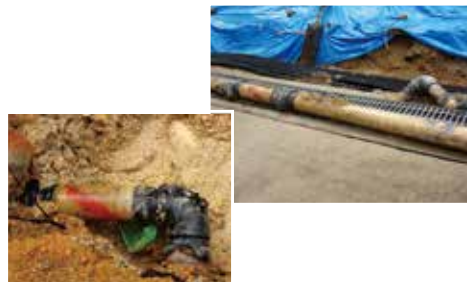
● 鋼管接合部の腐食
